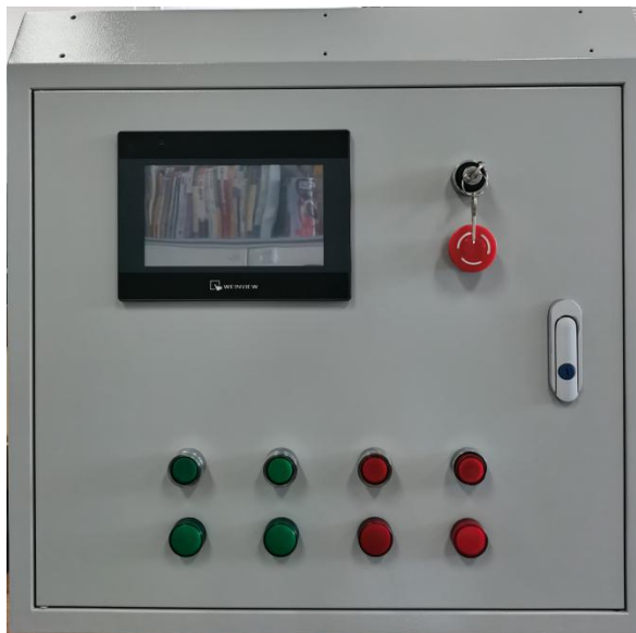
图 5-4 控制柜/室实物图
